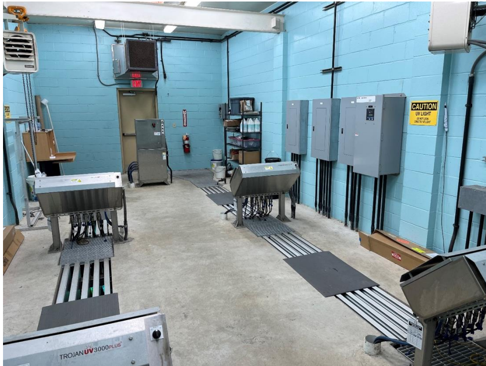
Fig. 21 – 2010 Infrastructure Project – U. V. Désinfectant
